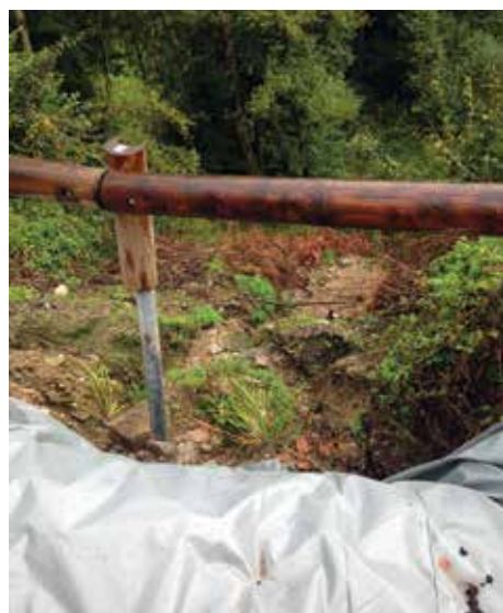
Suite aux intempéries de fin août, l'accotement s'est effondré à Maison Neuve. Une étude géotechnique a été diligentée pour la suite à donner aux travaux de réfection. L'accès reste sûr et non dangereux
